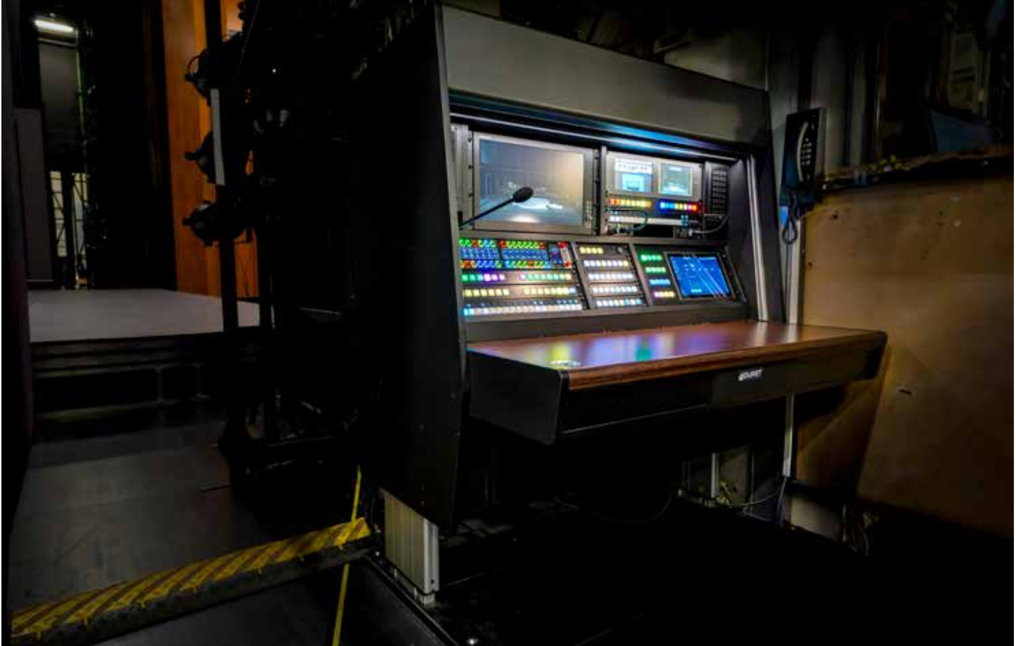
Eines der beiden Haupt-Inspizientenpulte im Bereich des Bühnenportals. Foto: Graner+Partner
