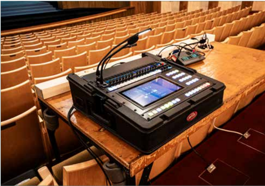
Mobiles Inspizientenpult am Regieplatz im Saal der Oper Leipzig. Foto: Graner+Partner
