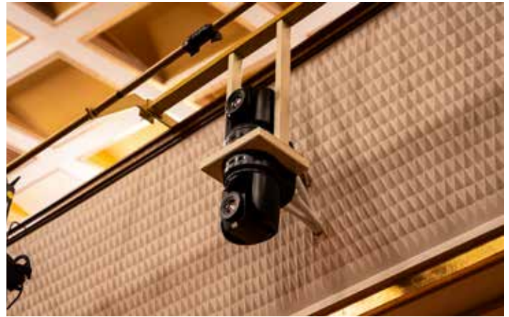
PTZ-Kameras installiert im Zuschauerraum in einer Sonderkonstruktion als Halterung
