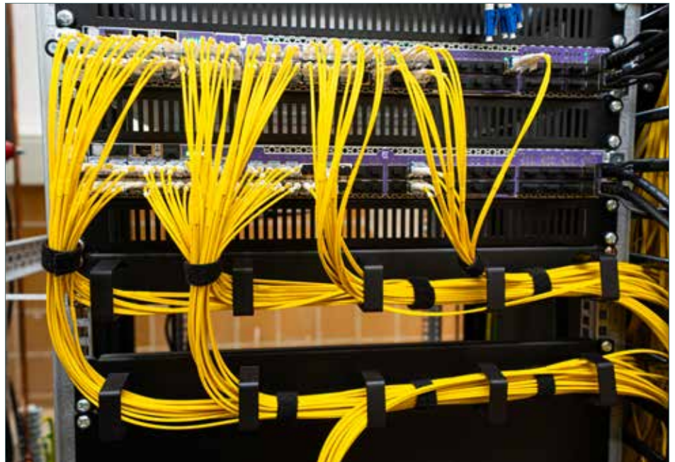
Glasfaser-Sternpunkt in der Hauptzentrale mit redundanten Core-Switches
